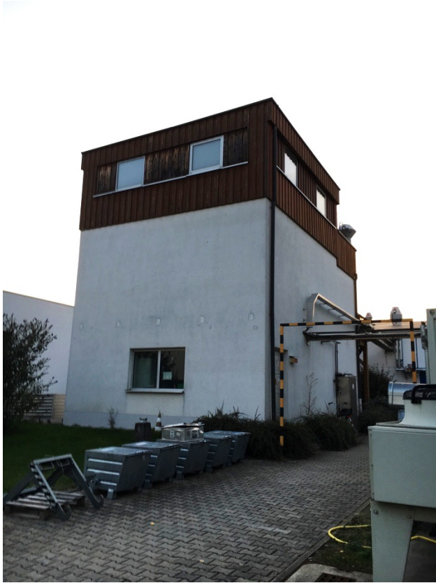
Abb. 2: Bau 40-C: Holzverkleidung, überlappend, an Gebäude Eingang C, bis ca. 2,5 m unter Trauf
