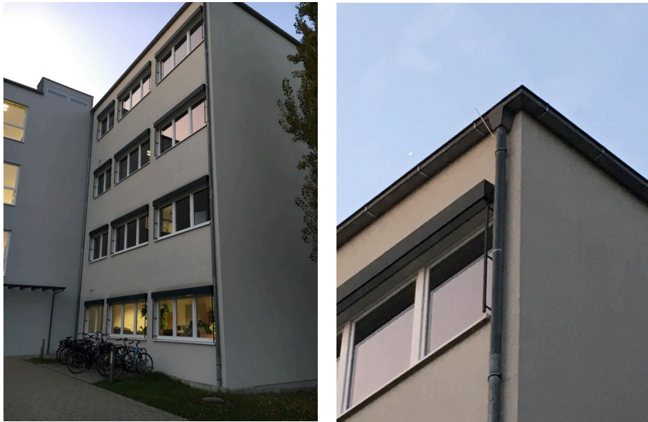
Abb. 4: Bau 38: Gemauerte und verputzte Fassade; Spalt hinter Regenfallrohr
