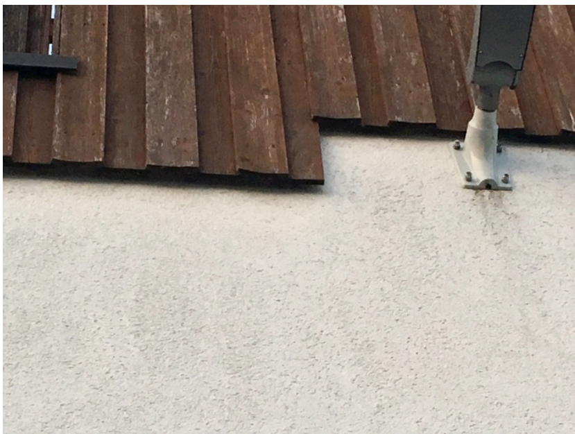
Abb. 3: Bau 40-C: Holzverkleidung, Spalten hinter der Holzverkleidung als Quartier für Spaltenbewohnende Fledermäuse geeignet
