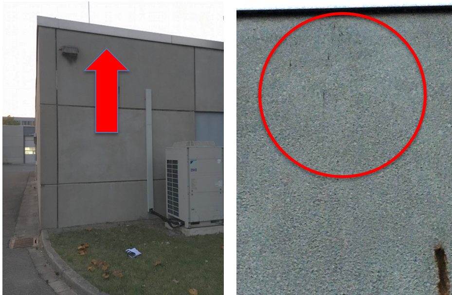
Abb. 8: Bau 46: Mögliche Kotspur am Mauerwerk (Lage angezeigt durch roten Pfeil), Hinweis auf potenziellen Fledermausbesatz hinter dem Traufblech
