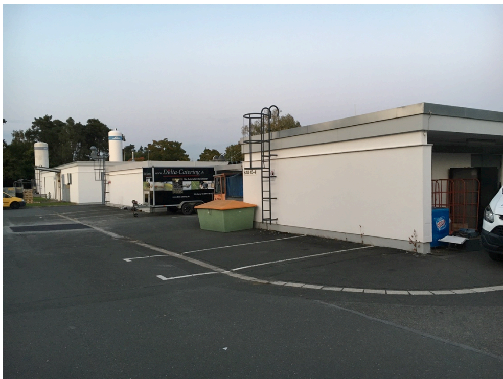
Abb. 5: Bau 45-2 bis 45-4: Verputzte Fassade; Blechverkleidungen unter Trauf, Spalten zum Teil vorhanden (siehe Tabelle 2)
